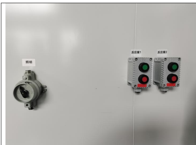
照片 7 合成车间防爆开关和按钮
