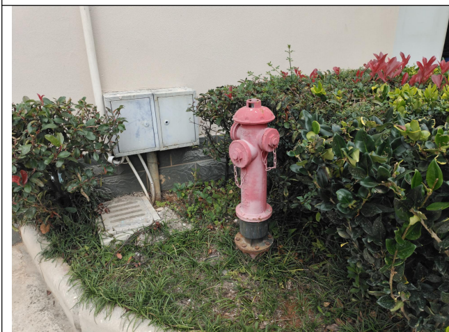
照片 3 室外消火栓
