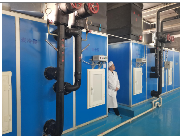
照片 15 制剂车间空调机房
