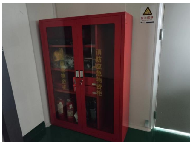
照片 8 合成车间门口消防器材柜
