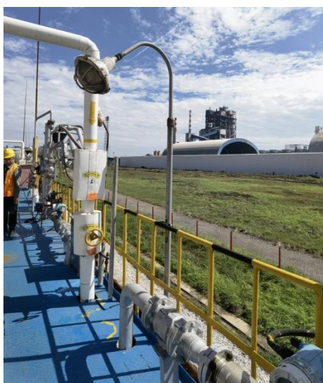
图 2-5 栈桥照明设施
