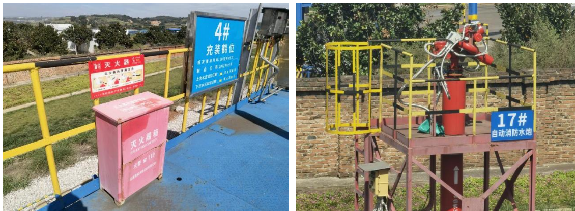
图2-7 消防灭火设施
